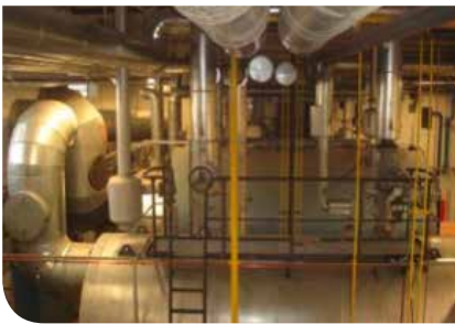
Feuerungsanlage Werk IV
