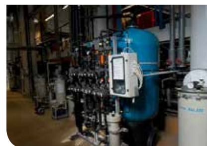
Ionenaustauscher zur Standzeitverlängerung TSA
